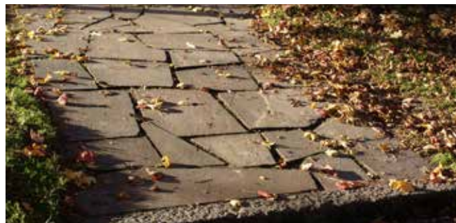
Skifer/bruddheller med for store fuger.
